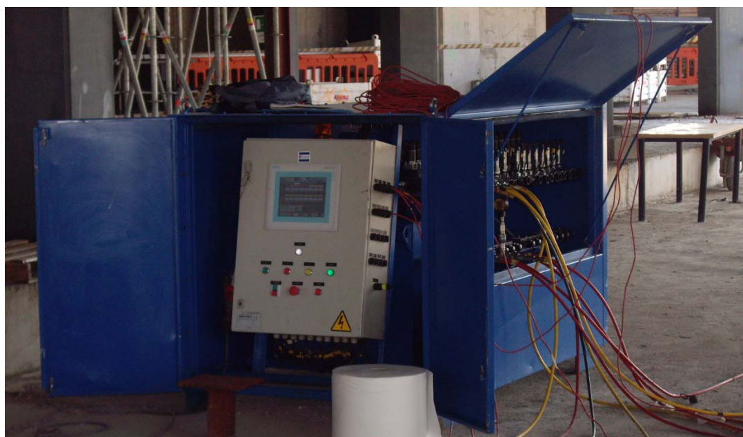
Figura 8. Central hidráulica automatizada (FREYSSILAO).
