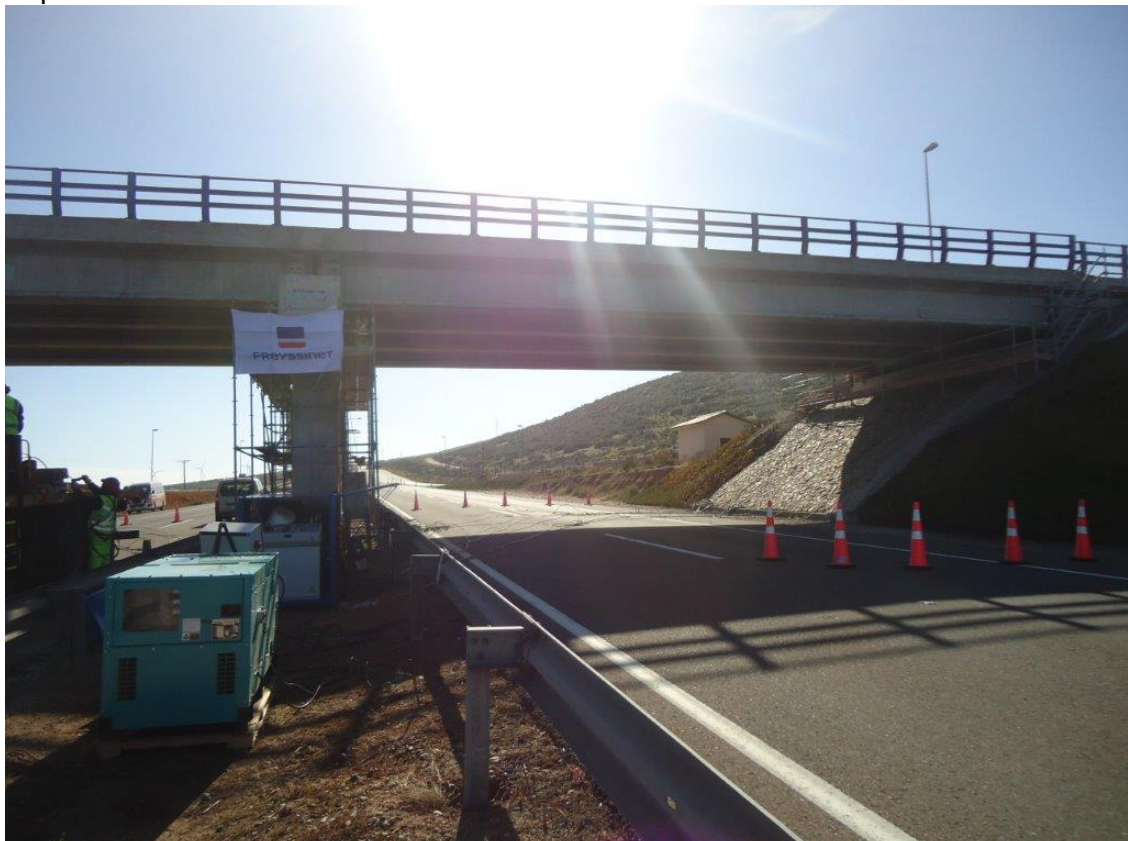
Figura 3. Vista general Puente (momento de corte de tráfico para realizar el ripado)
